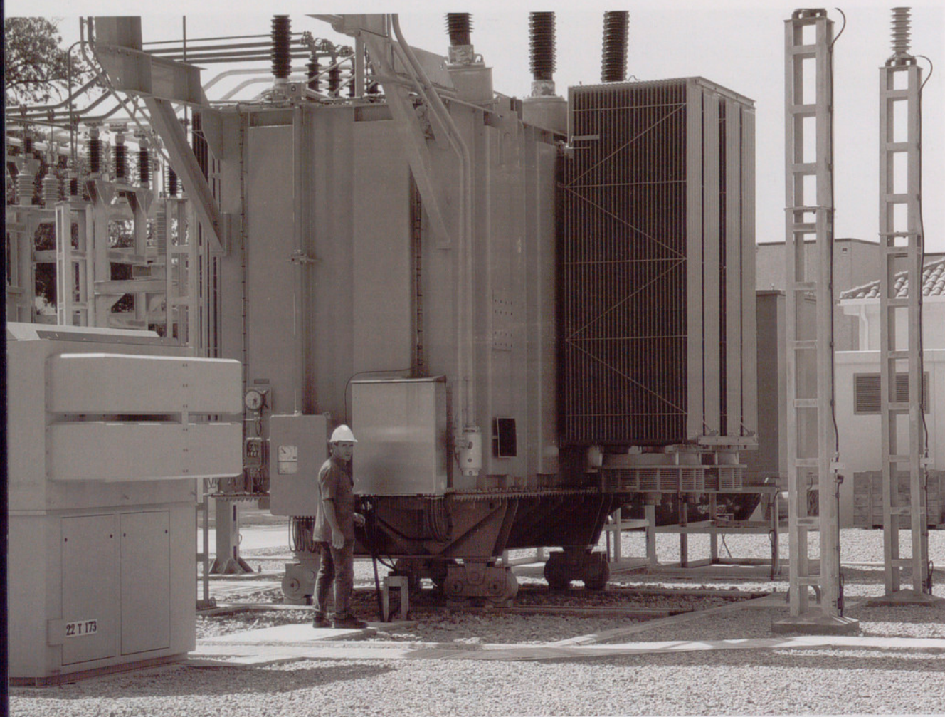
Detall del transformador de l'estació receptora de Can Margens.
