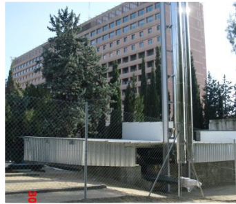
Instal·lació de biomassa al Consorci Sanitari de Terrassa
