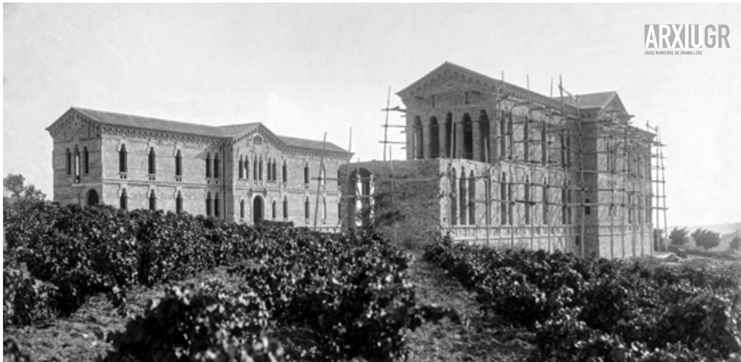
Construcció dels principals pavellons de l'Hospital-Asil, 1916-1918. Fotografia d'autoria desconeguda / Fons Fundació Privada Hospital Asil de Granollers
