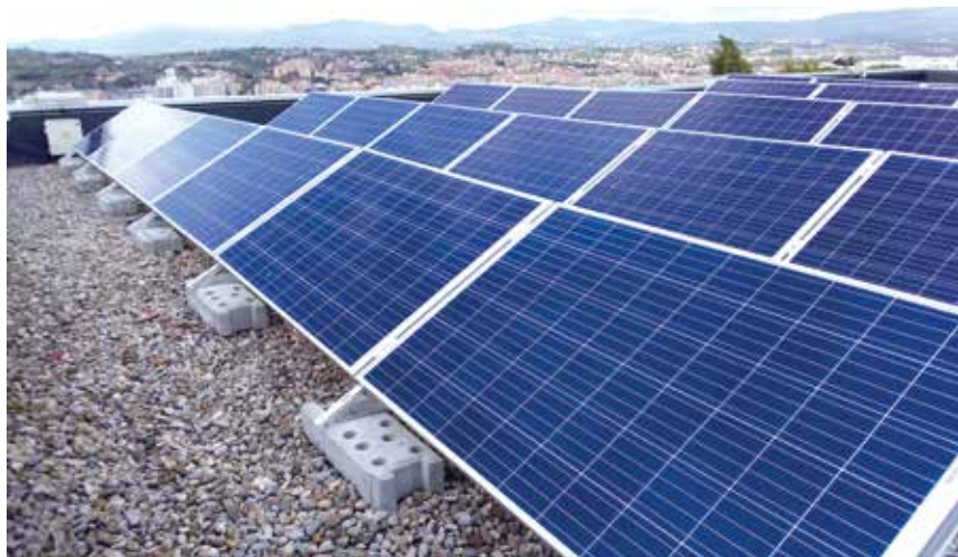
Mòduls fotovoltaïcs a la coberta d'un centre educatiu de la ciutat
